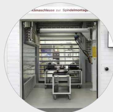
Klimaschleuse Waiting & tempering area
